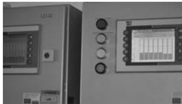
Контролна зала - мониторинг
